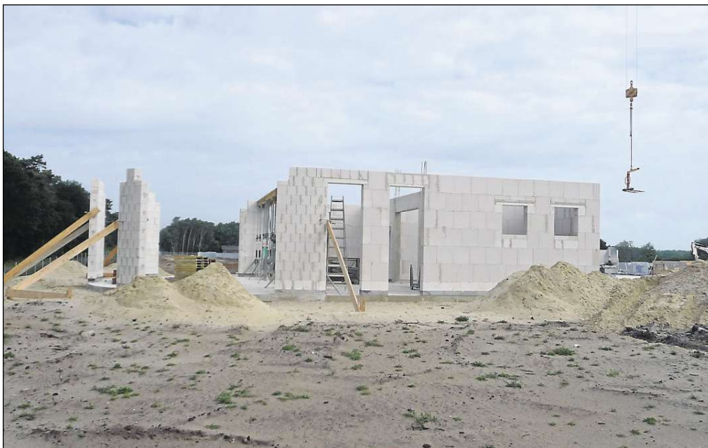
Es wächst: Der Rohbau des Europäischen Fachzentrums Moor- und Klimaschutz nimmt bereits Formen an. Eröffnet werden soll es im Herbst 2014 – und Jahr für Jahr bis zu 30 000 Besucher nach Wagenfeld-Ströhen ziehen. ■ Foto: Petra Herrmann
